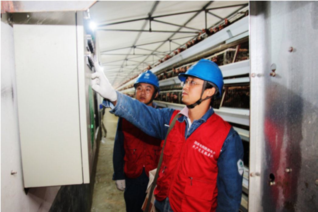
国网咸阳供电公司员工在渭滨镇留印村为村民的养殖厂检查用电设备
