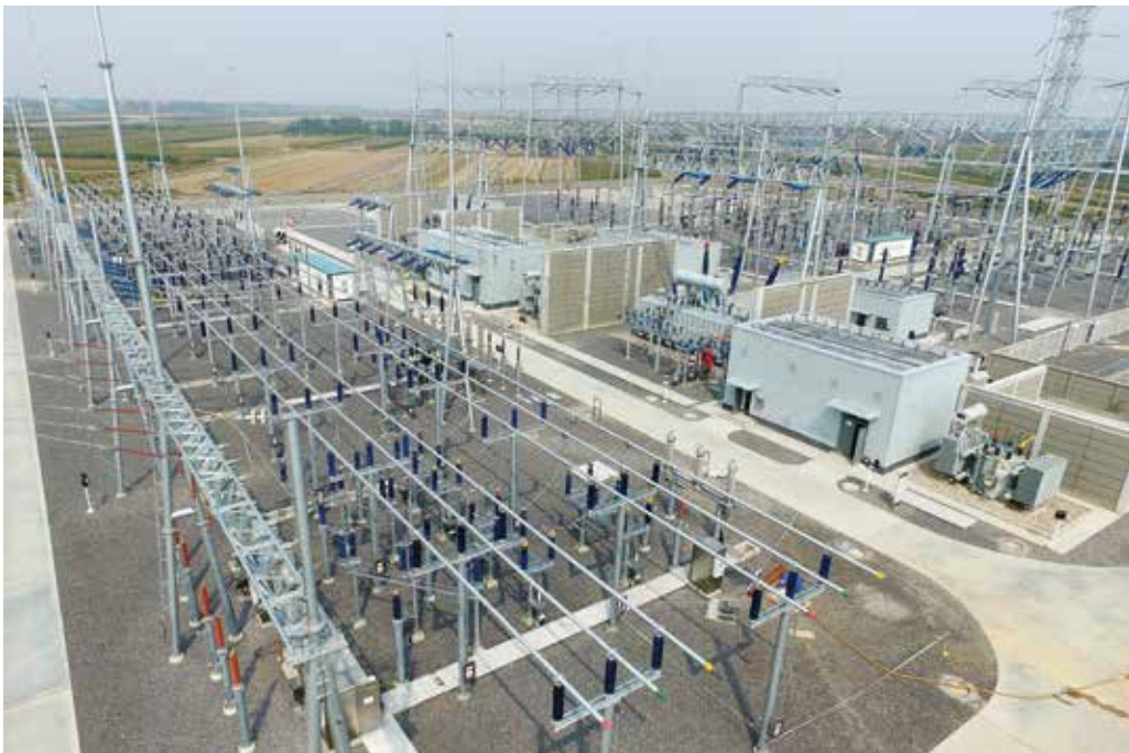
富平 330 千伏新一代智能变电站
