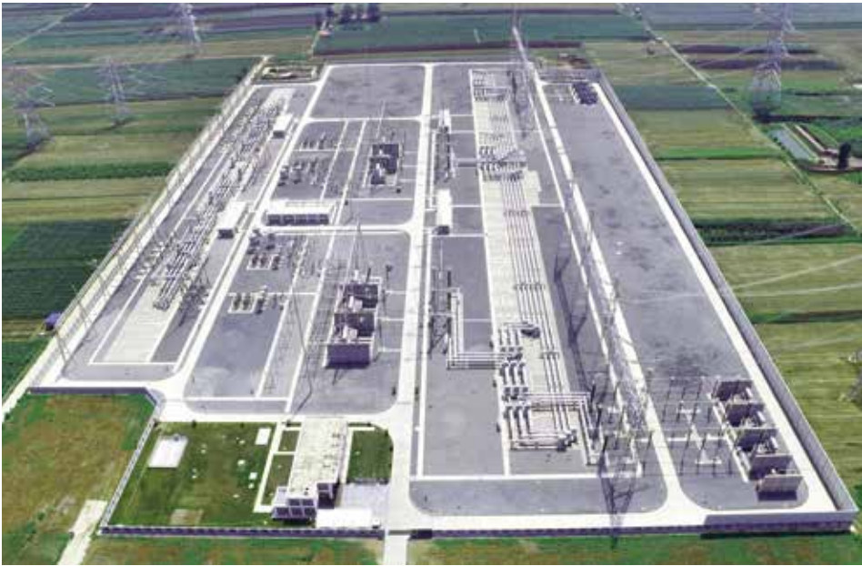
西安南（南山）750 千伏变电站
